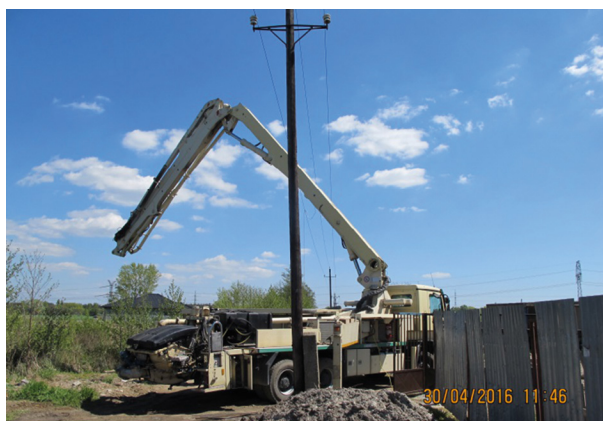
Kontakt betónovej pumpy s 22 kV vedením
