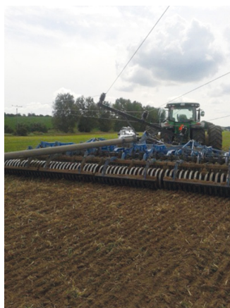
Traktor zvalil stĺp 22 kV vedenia
